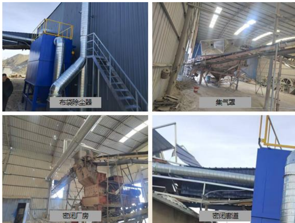
图 3-1 废气处理设施照片
